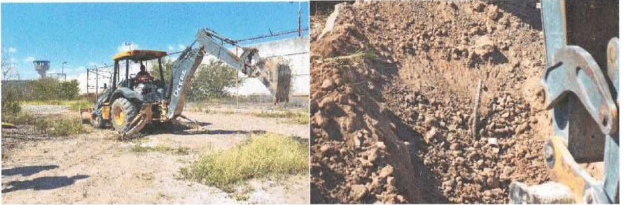
Fotografía 9.- Excavación con supervisión donde se encontró varilla, zona 2
