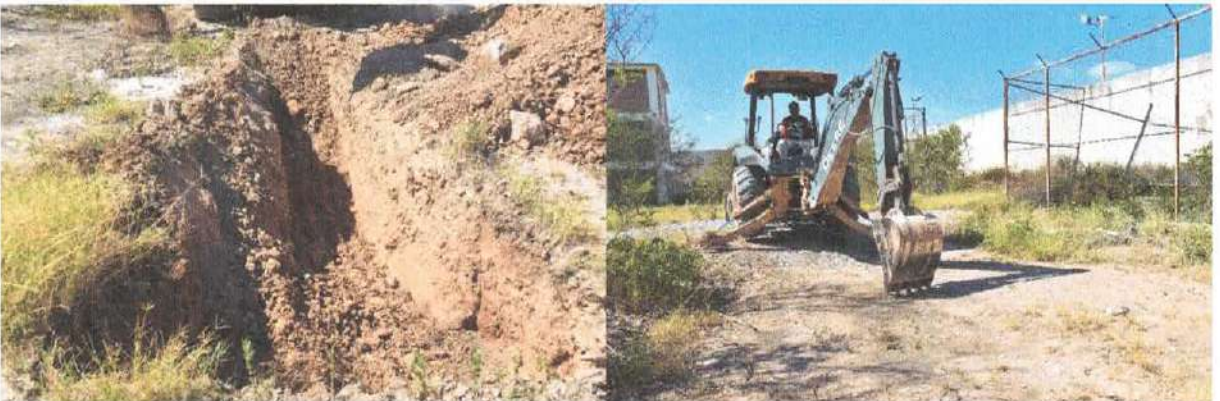
Fotografía 10.- Excavación con supervisión donde se encontró varilla, zona 2
