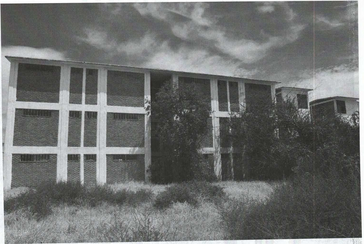
Plano medio donde se observa el exterior del edificio de las celdas de las antiguas instalaciones del centro de readaptación social de Gómez palacio dgo, señalado como "Edificio A".
