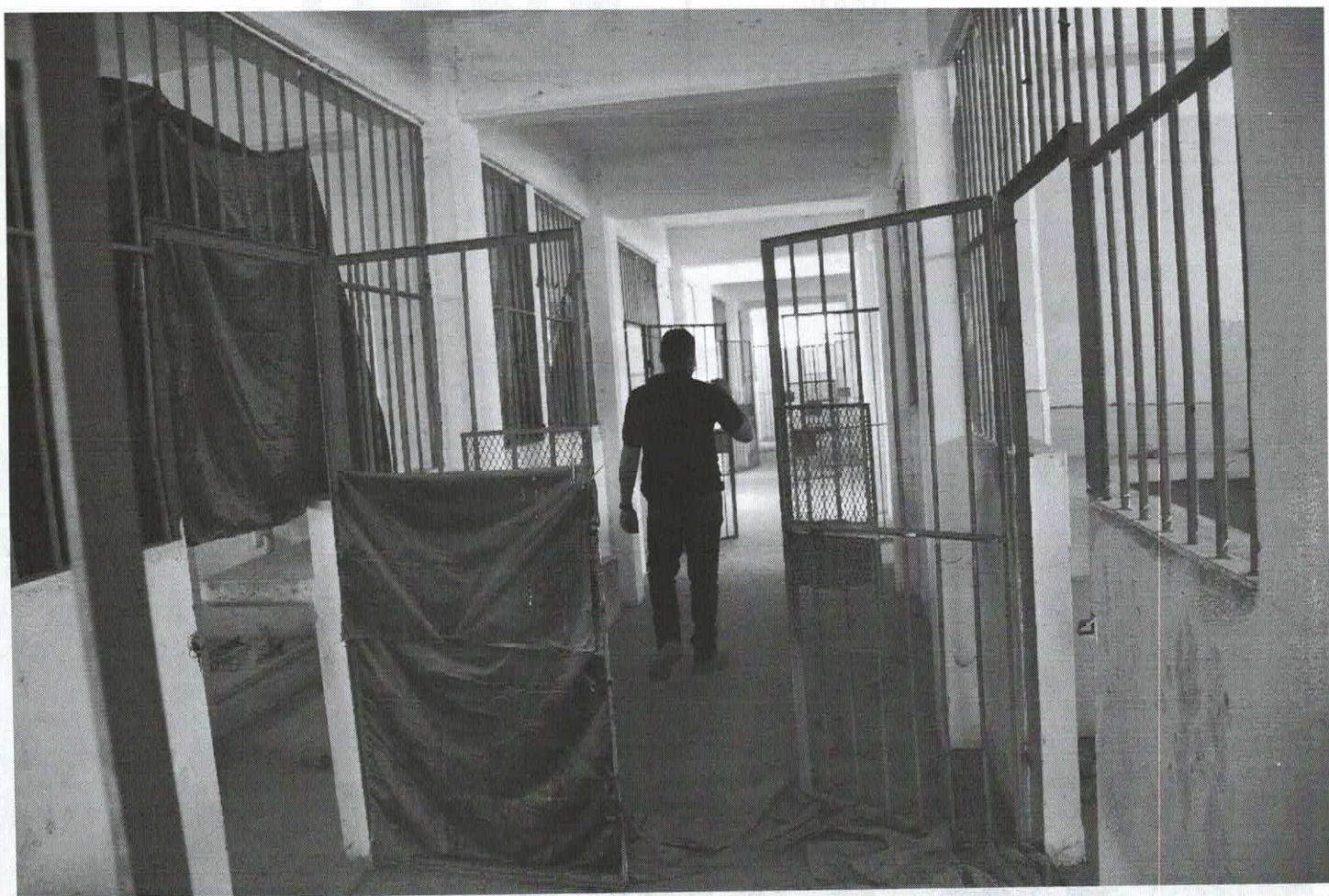
Plano medio donde se observa el interior del segundo piso del edificio "A" de las antiguas instalaciones del centro de readaptación social de Gómez palacio dgo.
