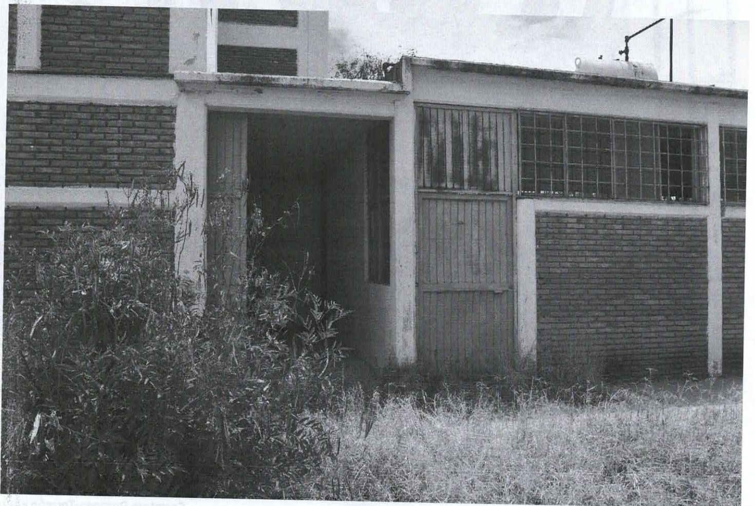
Plano medio donde se observa el acceso al interior del edificio "C" de las antiguas instalaciones del centro de readaptación social de Gómez palacio dgo.
