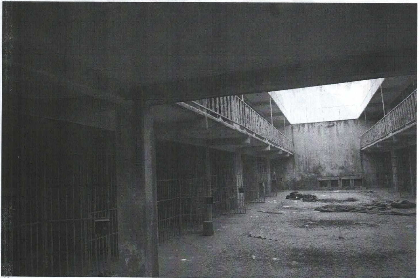
Vista media donde se puede apreciar el interior del área de celdas para hombres, observándose las condiciones en las que se encontró.
