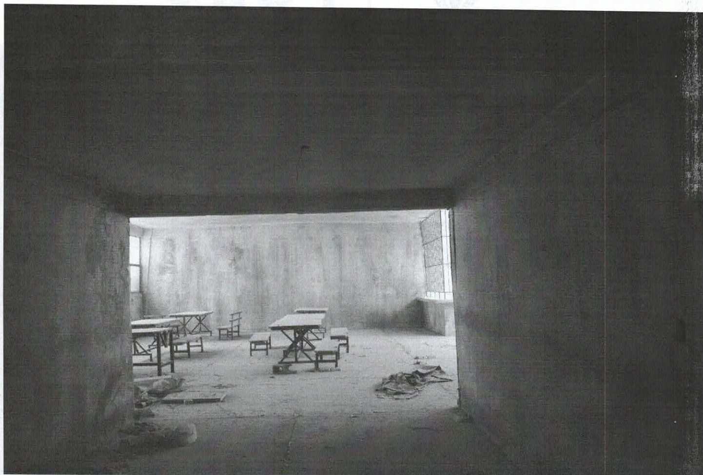
Vista media donde se puede apreciar el área del comedor de las celdas de hombres, observándose las condiciones en las que se encontró.
