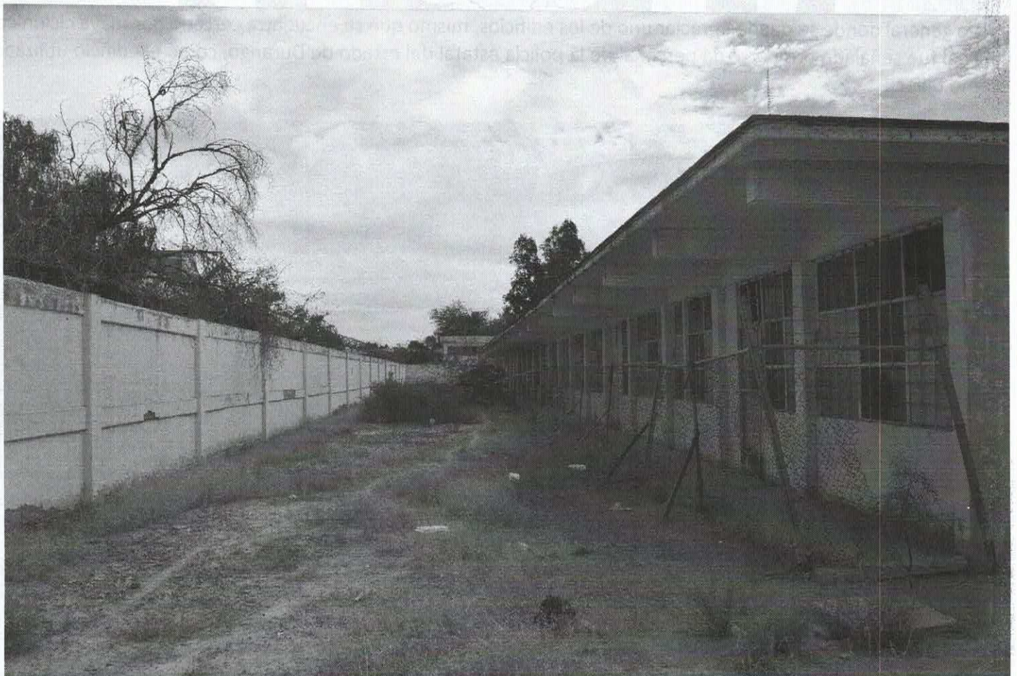
Vista general donde se puede apreciar el área que se encuentra en la parte posterior del edificio de taller, observándose las condiciones en las que se encontró.
